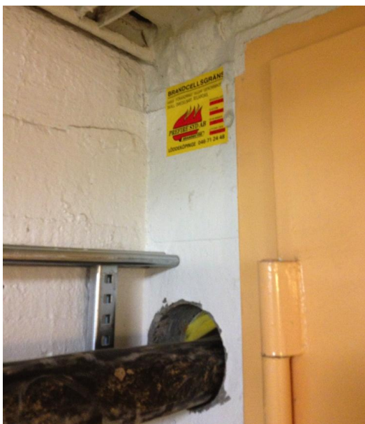
Bild 9: Brandcellgräns där genomföring blivit korrekt tätad men vid ett senare tillfälle har en ny håltagning gjorts vilken ej har blivit tätad.
