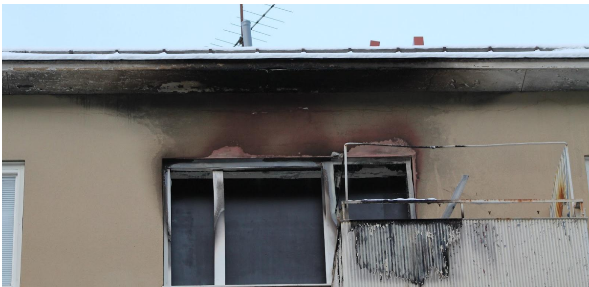
Bild 7: Exempel på hur en tät takfot av obrännbart material lyckats förhindra en brandspridning till vind (Foto: Lars-Göran Nylén)
